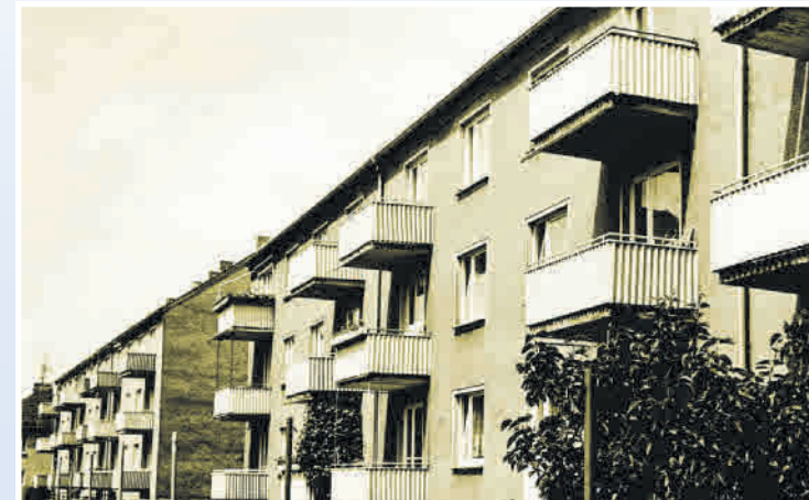
Die alten Balkone sollten schon vor 1990 gesperrt werden, wenn keine Sanierung erfolgt. Die Bewehrungen waren angerostet.
